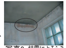
写真2 結露によるシミ
