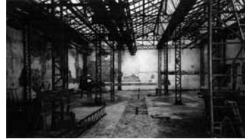
図-1 旧工場棟 鋸型屋根の構造体はかろうじて残っている。
